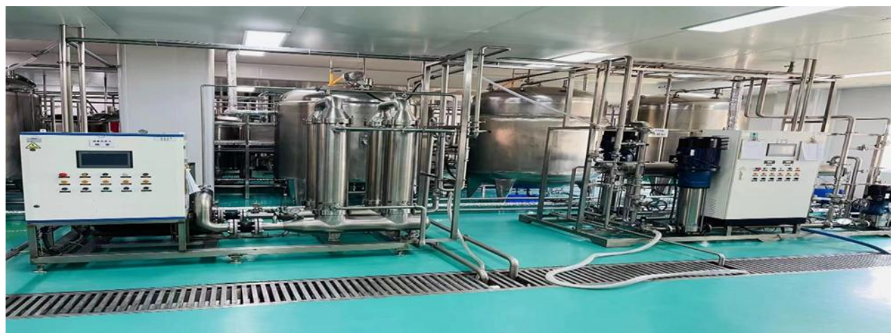
图3 精制车间设备
